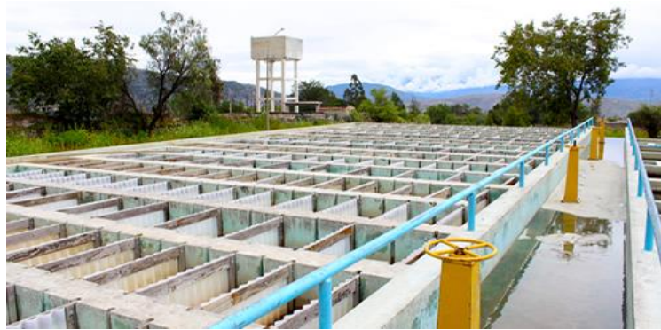
Foto 3 Floculadores de flujo vertical. Fuente. Registro fotográfico de EPSASA.
