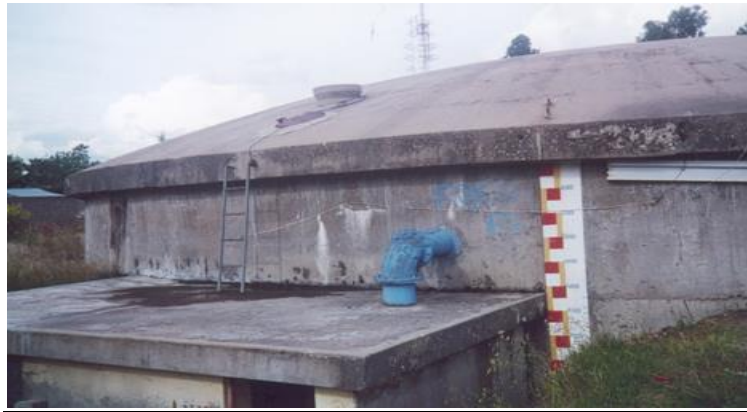
Foto 5 Reservorio de cabecera, 1500 m 3 Fuente. Registros de EPSASA.
