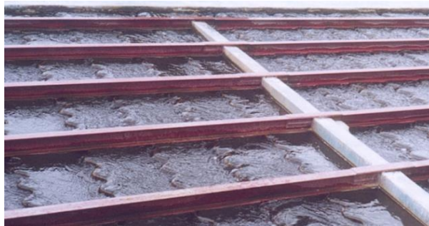
Foto 11 Unidad de floculación rápida Fuente. Registro EPSASA.
